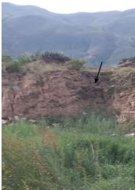
Foto 3: Perfil Sur otro ángulo donde se puede notar los muros en La parte superior impactado por la maquinaria pesada.
