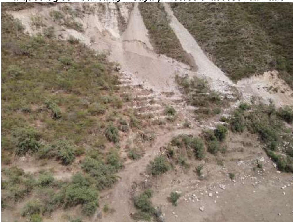
Vista aérea de la afectación de la andeneria prehispánica (paisaje arqueológico Huancaray – Sayar): Nótese el acceso realizado
