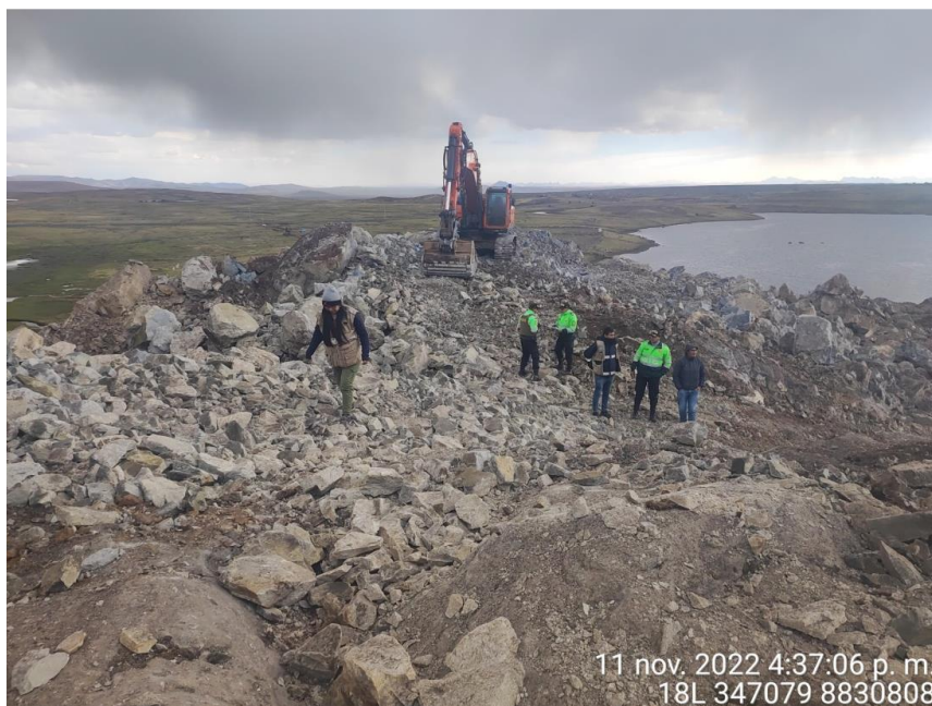
Foto N° 8: Detalle de la inspección ocular desarrollada por parte del suscrito supervisor de la DDC Pasco y apoyo policial al área donde se desarrolla trabajos de ingeniería por parte de la empresa F y A CONTRATISTAS S.A, los cuales vienen afectando todos los elementos culturales que forman parte del sitio arqueológico Gorgorin sector 2.
