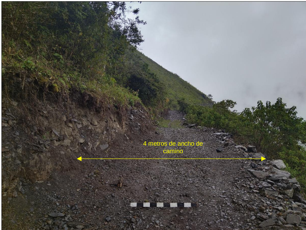
Vista donde se observa el trazo del camino afectado por la apertura de una trocha carrozable realizado de herramientas manuales.
