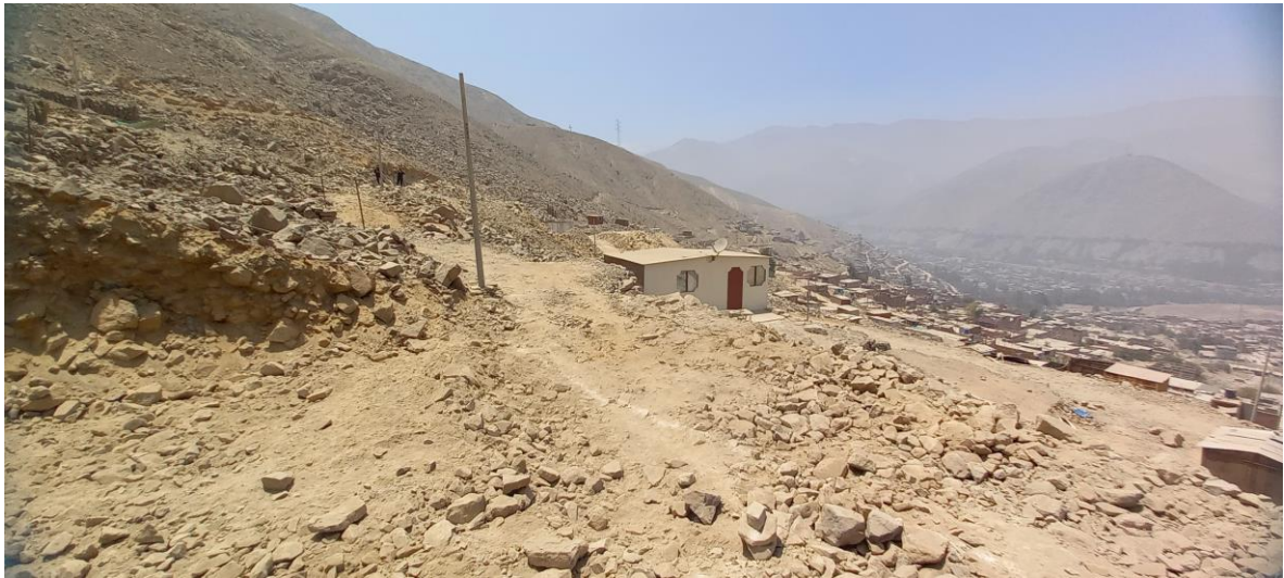
Foto 4: remoción y excavación de tierras para el asentamiento de estructuras, perdiendo la lectura de lo poco que queda de arquitectura prehispánica.
