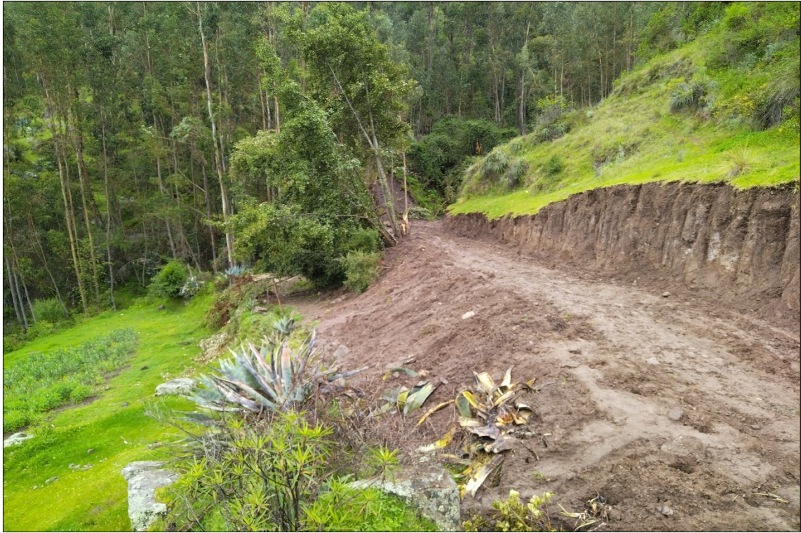
Imagen con DRONE del camino Huayqui – Acos, donde se observa el trazo del camino afectado por la apertura de una nueva trocha carrozable.
