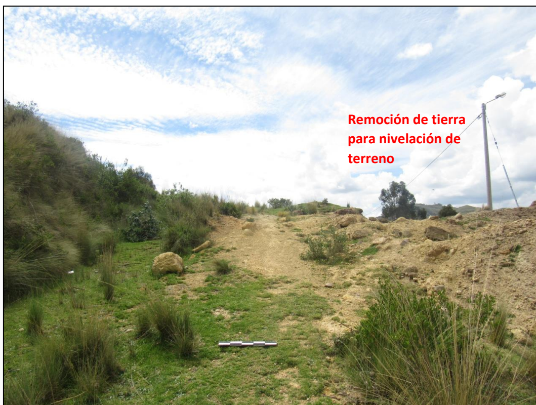
Segmento 2, el trazo del camino está siendo afectado por movimiento de tierras en predios colindantes y parte del trazo del camino.
