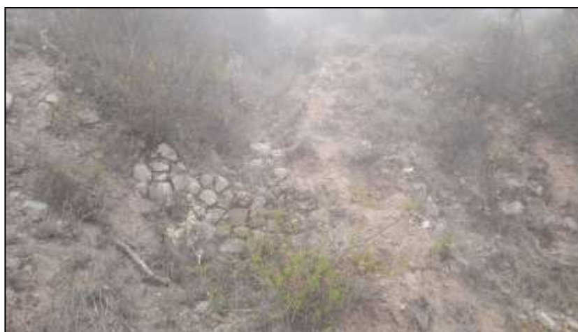
Imagen 06. Muros de andenería prehispánica expuestos y afectados por las excavaciones ilícitas.
