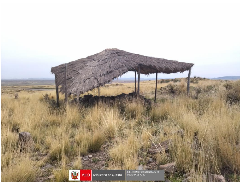
Imagen N° 21: Fotografía del colapso de la cobertura de paja de la chulpa en el sector II,
