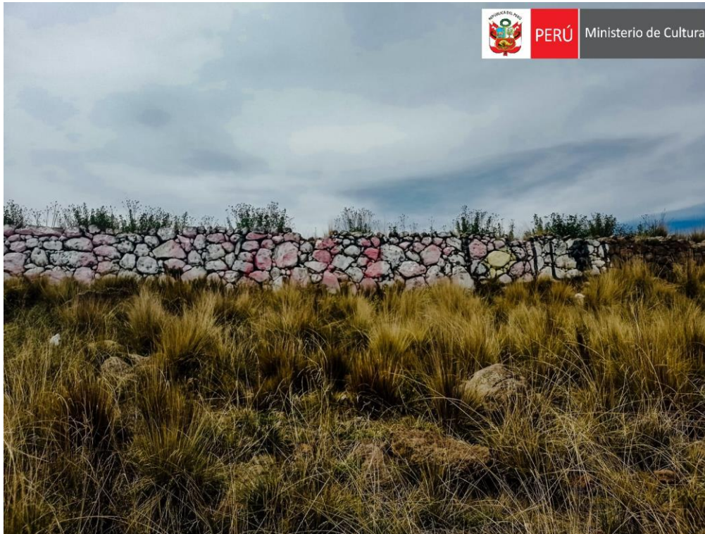
Imagen N° 40: Fotografía de la afectación de pintura política a un muro próximo a la vía asfaltada Puno - Juliaca
