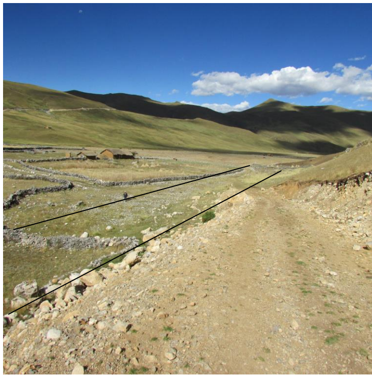
Foto 02. Véase la tierra que ha caído al camino inca y lo ha cubierto.
