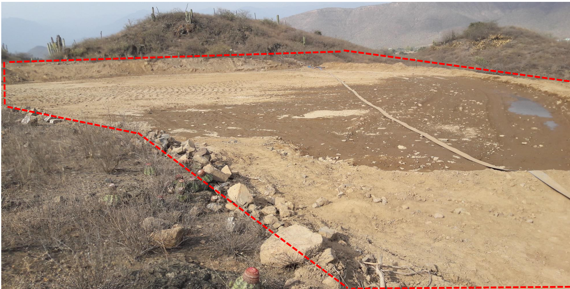
Imagen 05: Vista (de Oeste a Este) de la afectación 1 (delimitado con líneas punteadas rojas).
