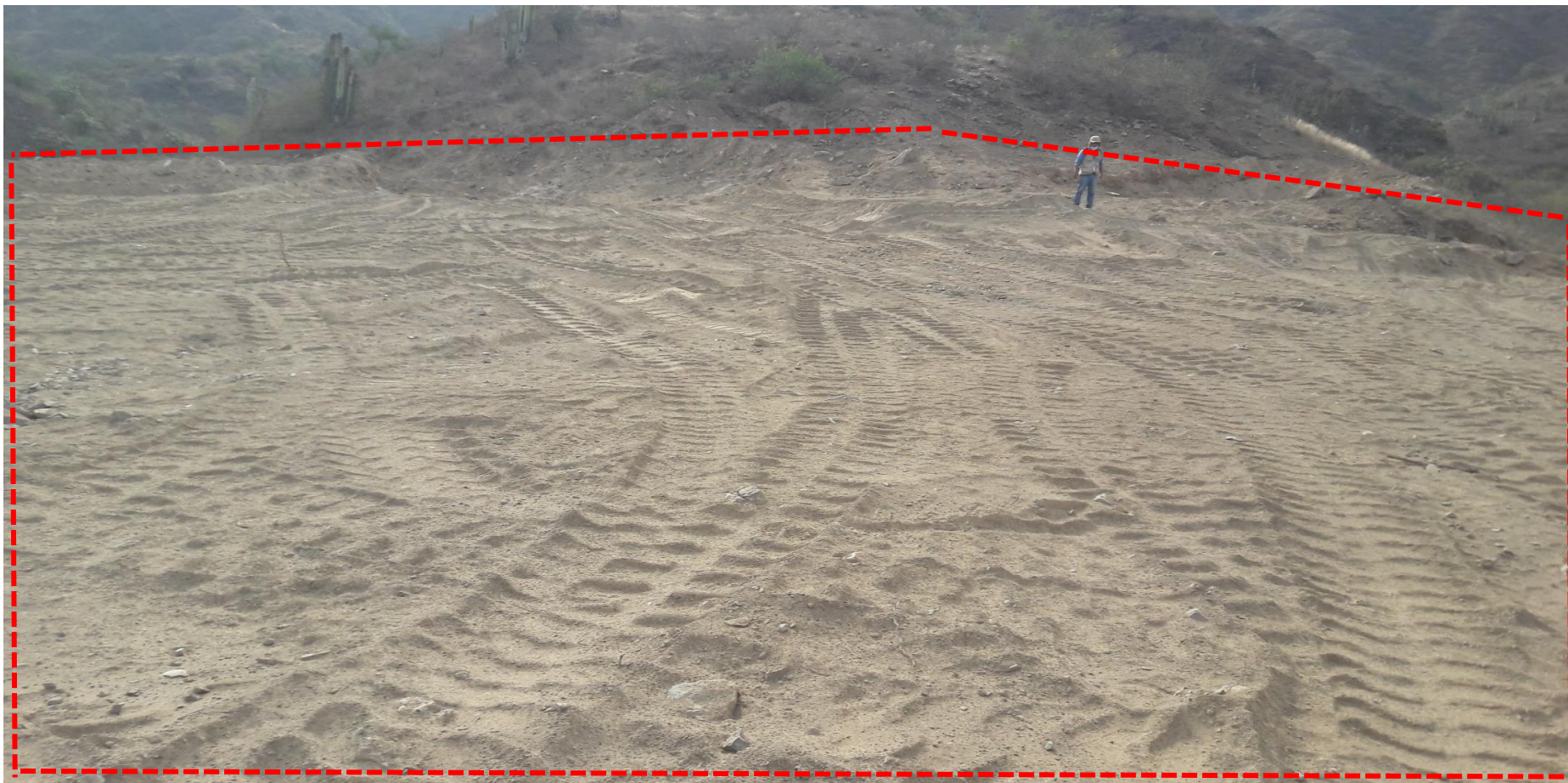
Imagen 06: Vista (de Oeste a Este) de la afectación 1 (delimitado con líneas punteadas rojas). Nótese las huellas dejadas por el tránsito de la maquinaria pesada.
