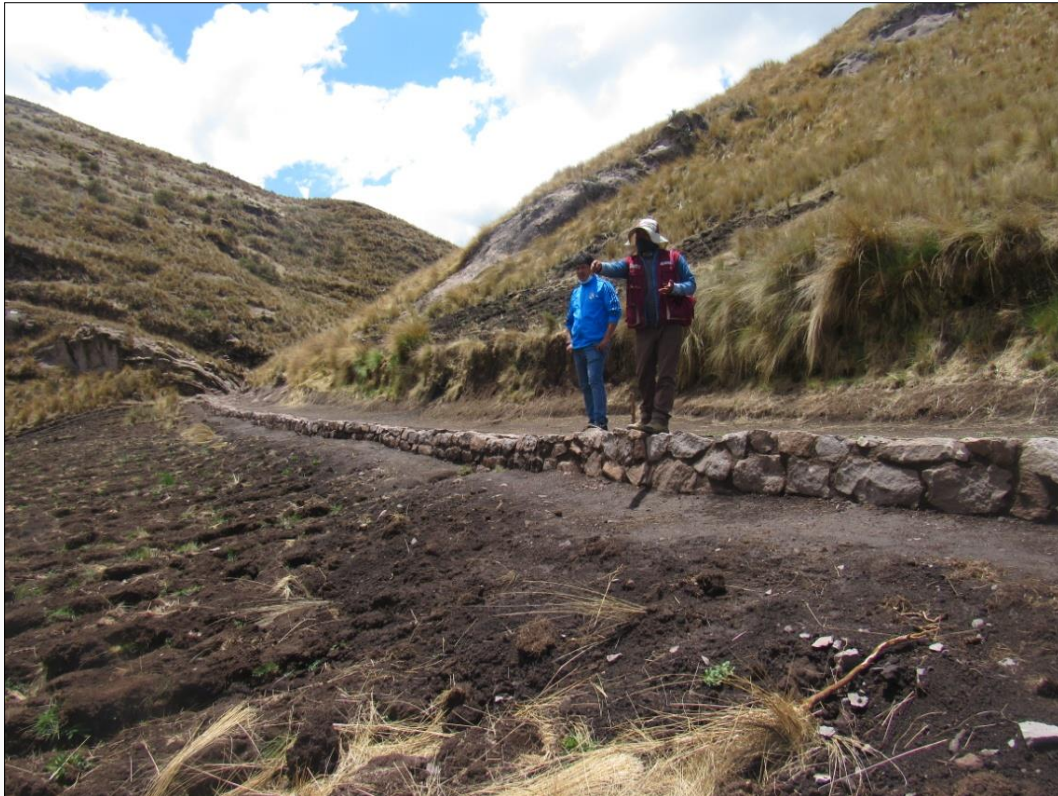
Vista del trazo del camino, que está siendo afectado por la ampliación de terrenos de cultivo en ambos márgenes del camino.
