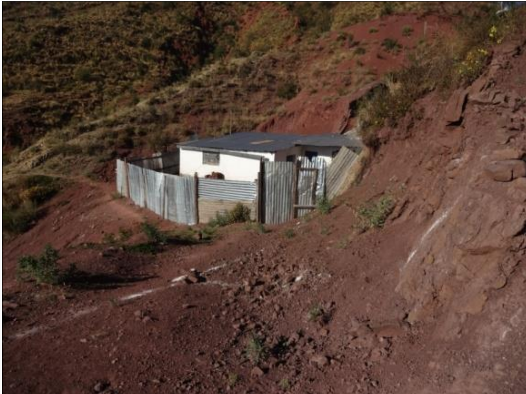
Vista de las lotizaciones y apertura de trochas carrozable, en predios colindantes y próximos al camino, que están generando la pérdida del trazo y componentes estructurales del camino.
