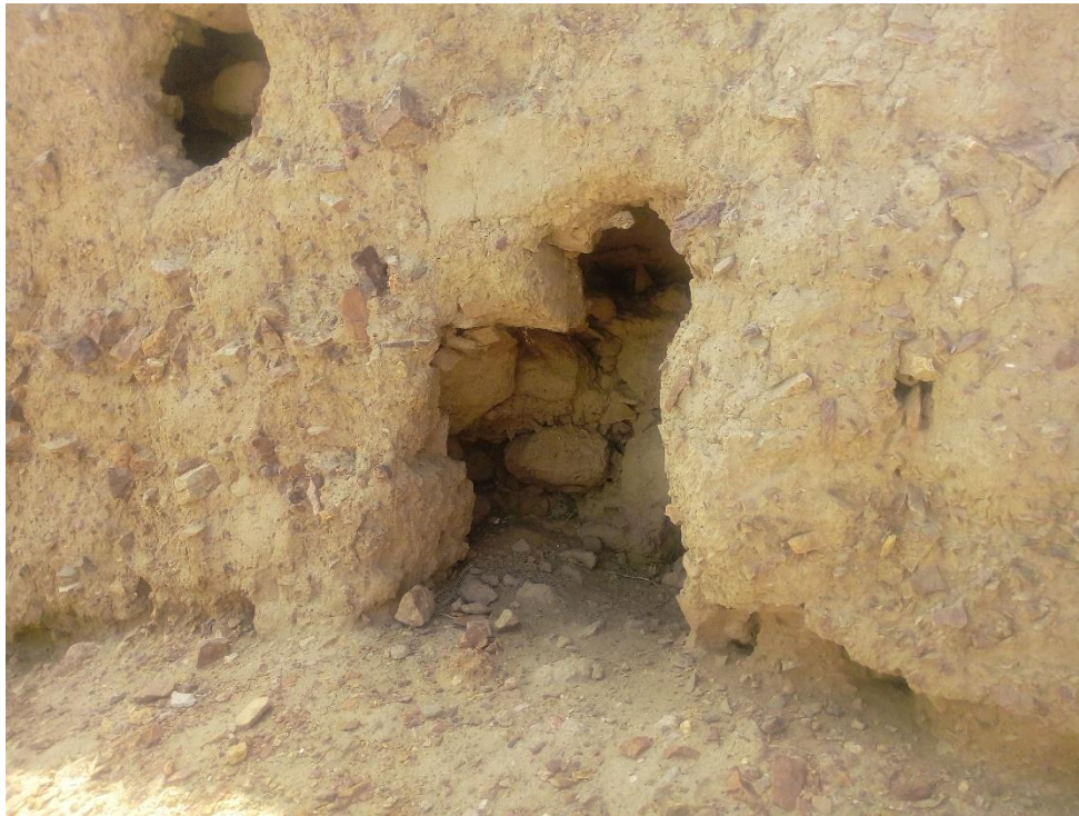
Imagen 13. Vista en detalle del muro, se observa el material y técnica utilizada para la construcción del muro trapezoidal, el mismo que se encuentra en mal estado de conservación.
