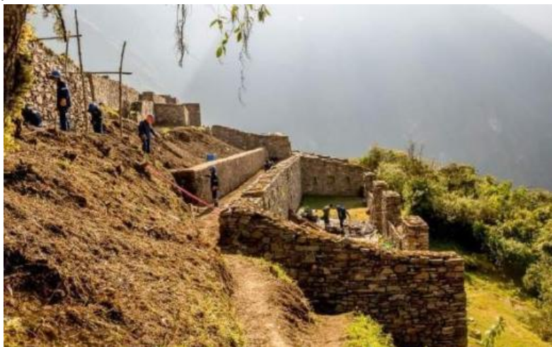
Foto 101: Sector Pikiwasi en proceso de restauración de recintos y muros de sostenimiento en 2009 por el proyecto COPESCO
