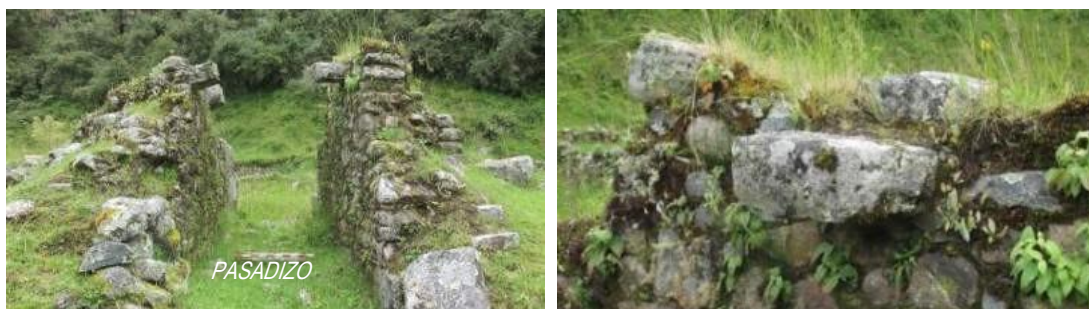
Fotos 66 y 67: Estado de conservación de las estructuras del sector Yuraqrumi, los muros de hallan debilitados por la erosión y cubiertos de vegetación, las estructuras se van colapsando progresivamente por la ausencia de acciones de conservación.
