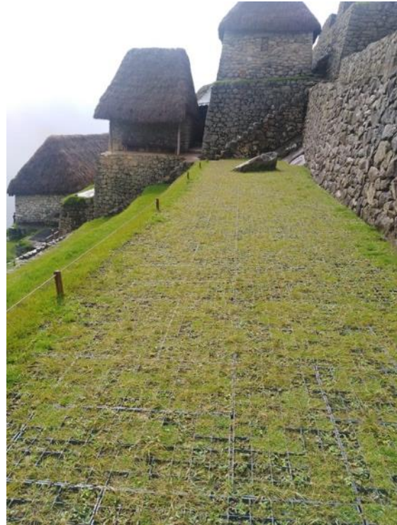
Figura 2: Parrillas drenantes totalmente mimetizadas con el entorno.
