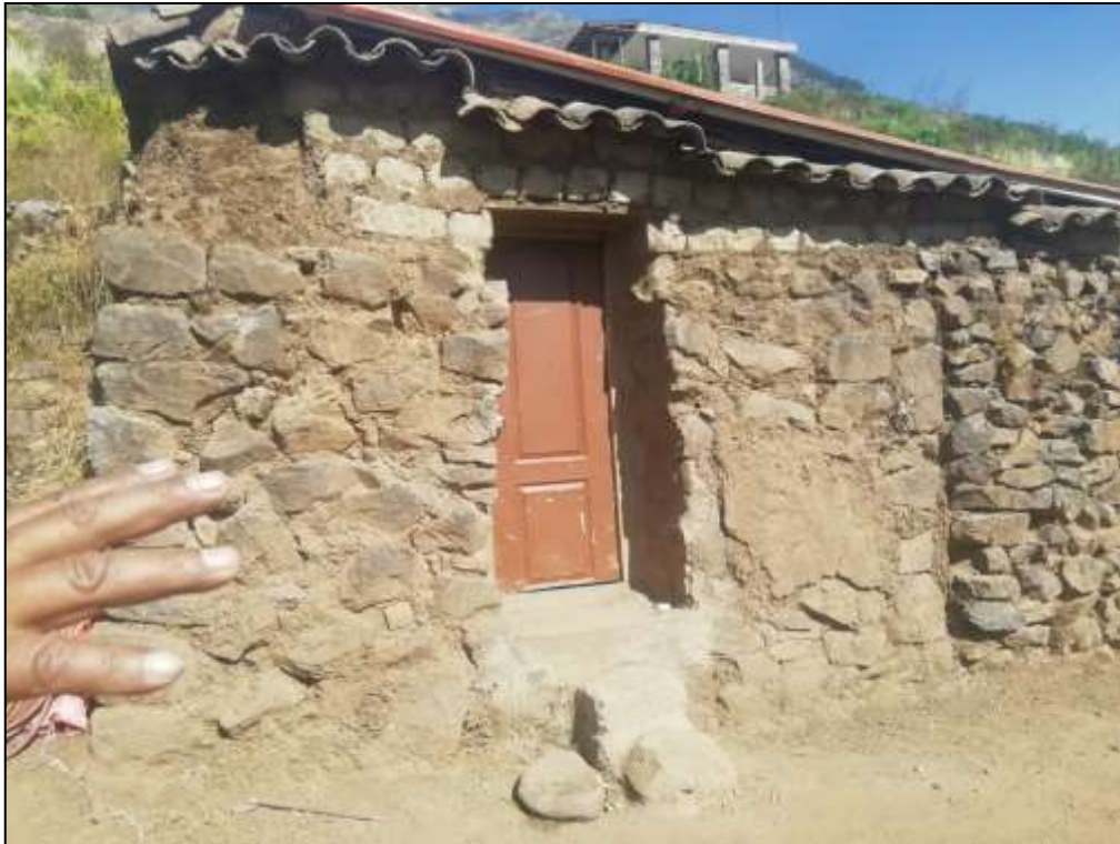
Foto N° 6. Apertura de vano de acceso y acondicionamiento de una escalinata rompiendo un muro prehispánico.
