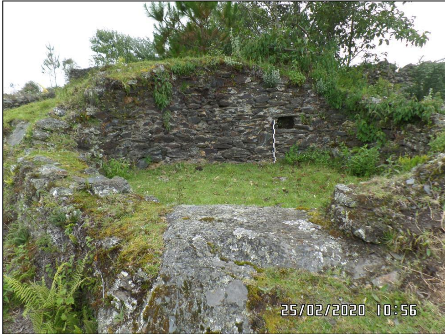
Imagen 04. Vista de una estructura que aún conserva su hornacina, el estado de conservación es regular.
