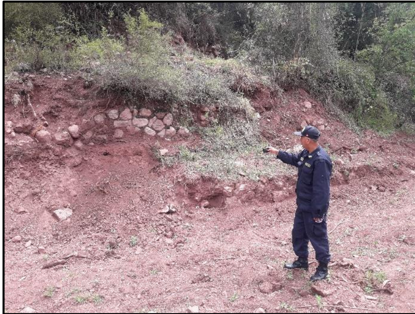
Foto N° 02: Vista de la afectación de los muros de contención, por ampliación de terrenos de tipo agrícola.
