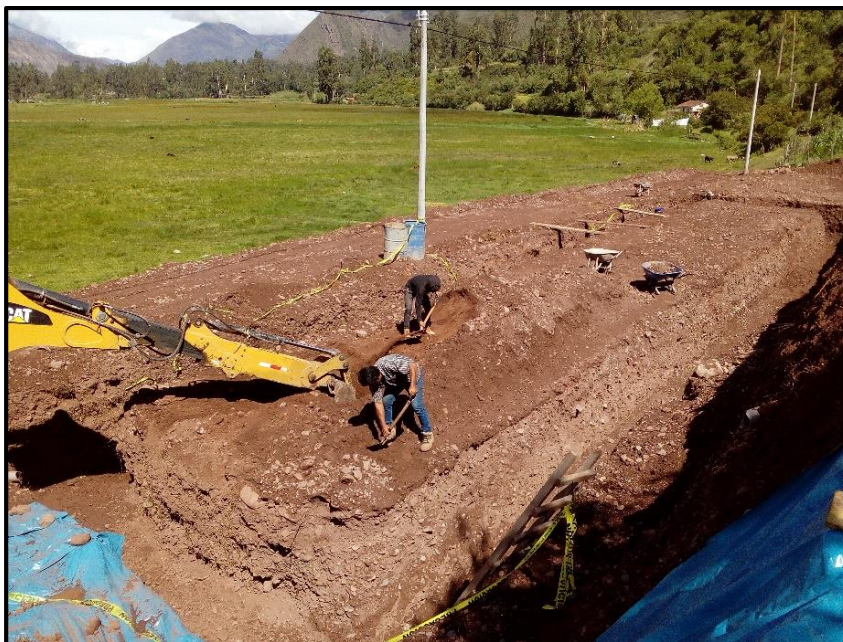
Foto N° 03: Vista de la remoción de suelo con maquinaria pesada alterando el paisaje cultural y natural del sitio, donde se evidenció muros recintos
