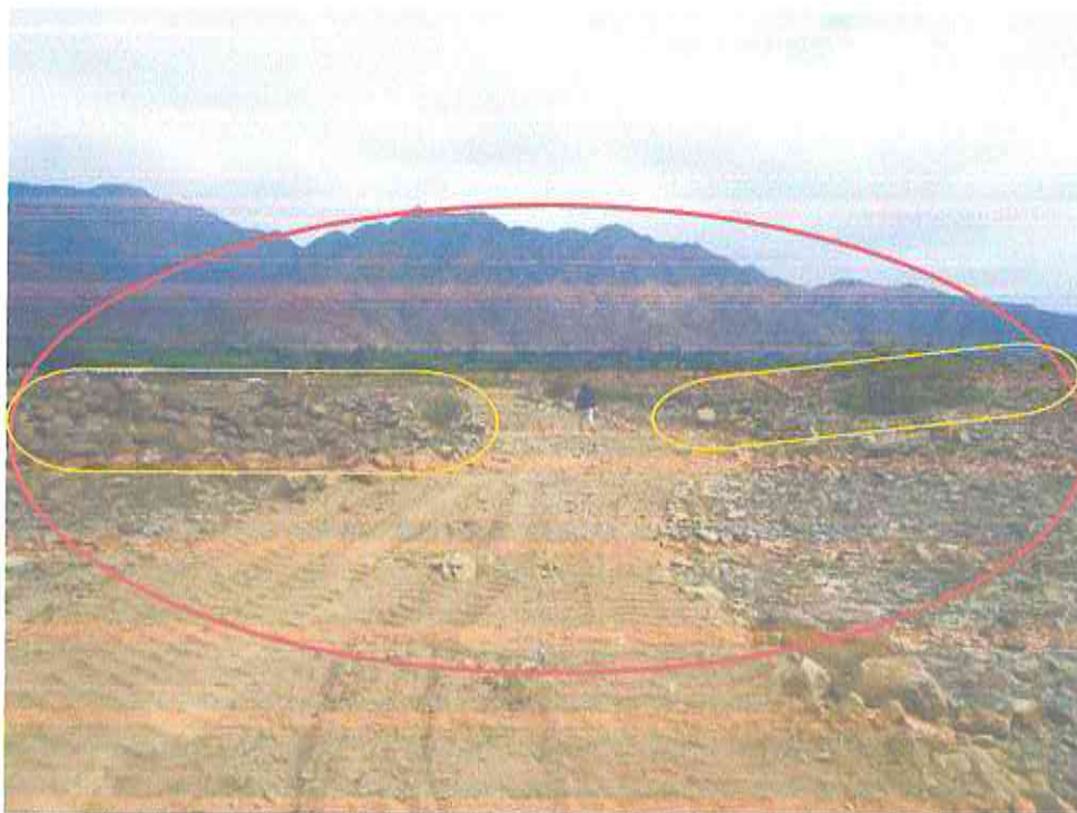
Foto 18. Vista panorámica de habilitación de la trocha, la misma que afecta de manera directa al sitio arqueológico, cercenando parte de una muralla arqueológica (nótese en amarillo).
