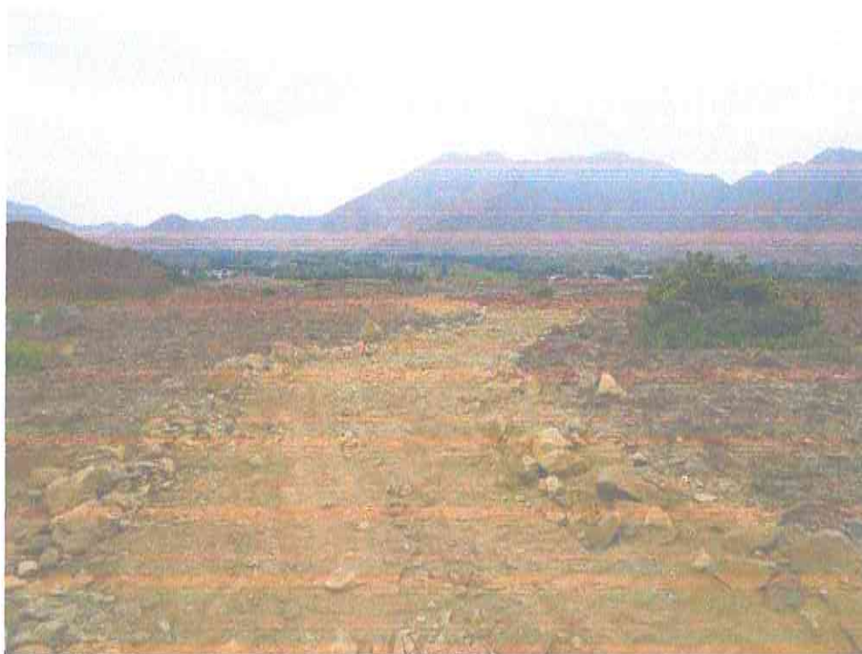
Foto 16. Vista panorámica de habilitación de la trocha, la misma que afecta de manera directa al sitio arqueológico.
